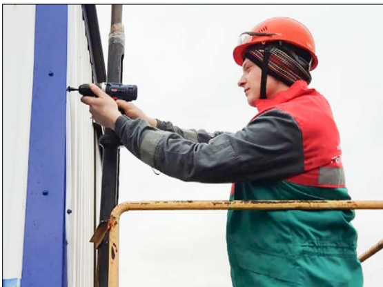
Работники трудятся над приведением бригадного хозяйства в надлежащее состояние. / ФОТО: НИКОЛАЙ НЕМЦОВ, АЛЕКСАНДР РЕШЕТОВ, «ЕВС».
